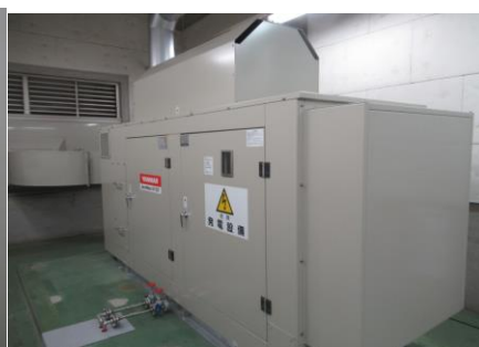
非常用発電設備
